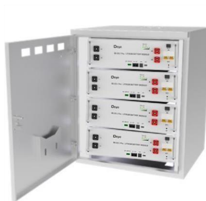
W szafie rack
